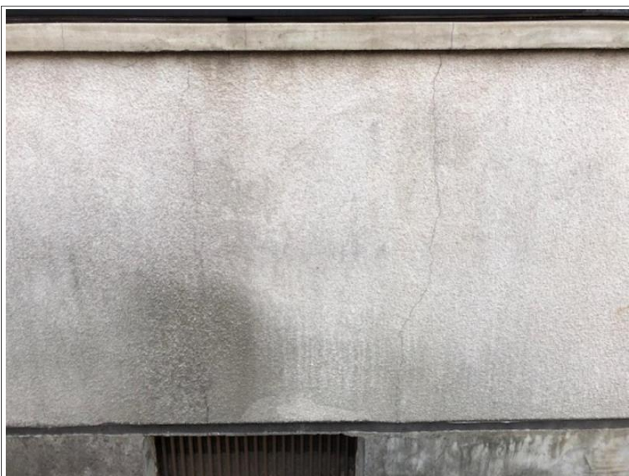
外壁 クラック部
