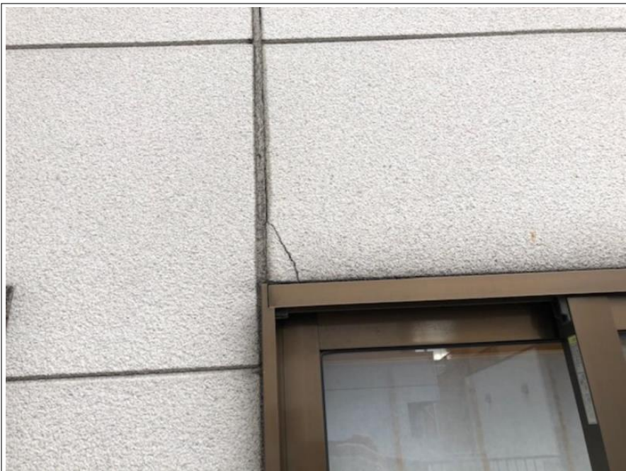
外壁 クラック部
