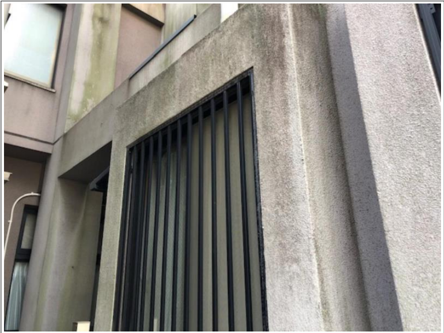
外壁 カビ発生
