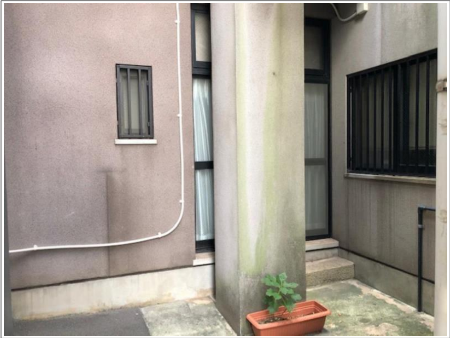
外壁 カビ発生
