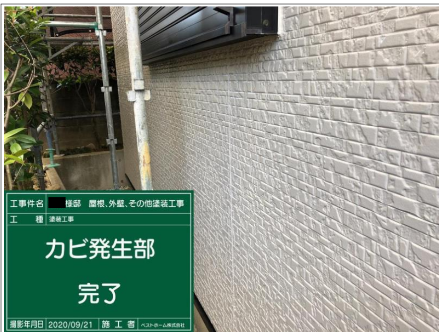
外壁 カビ発生部
