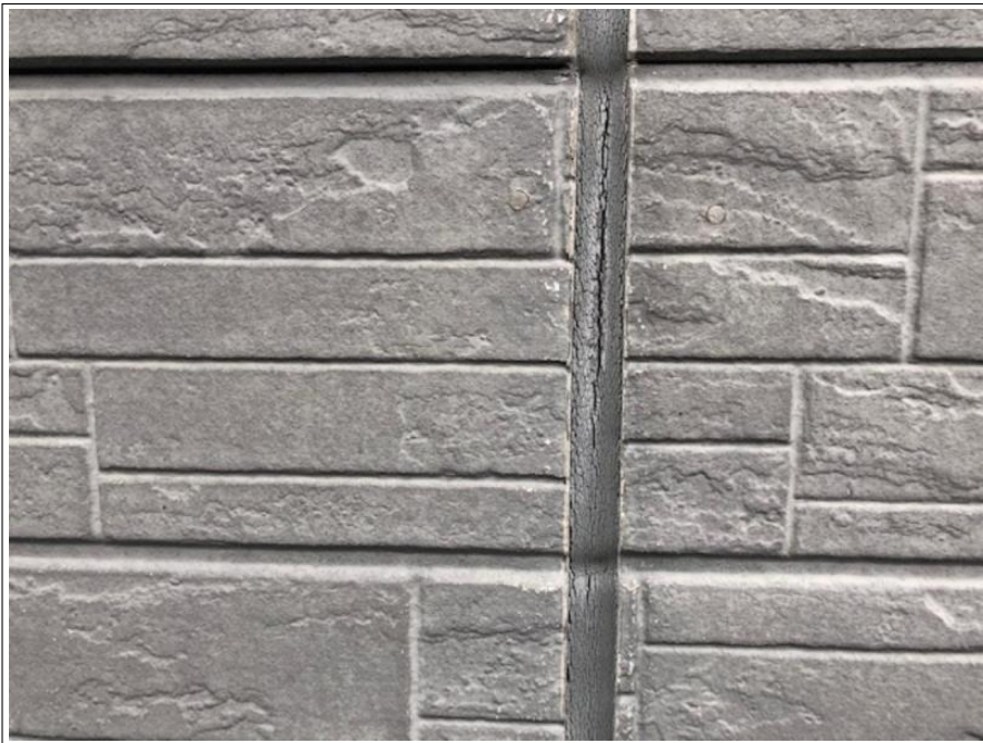
外壁 ボードシーリング劣化部
