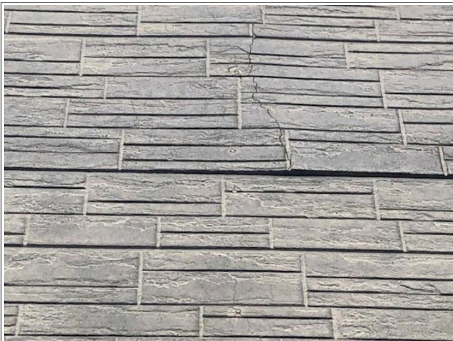
外壁 クラック部
