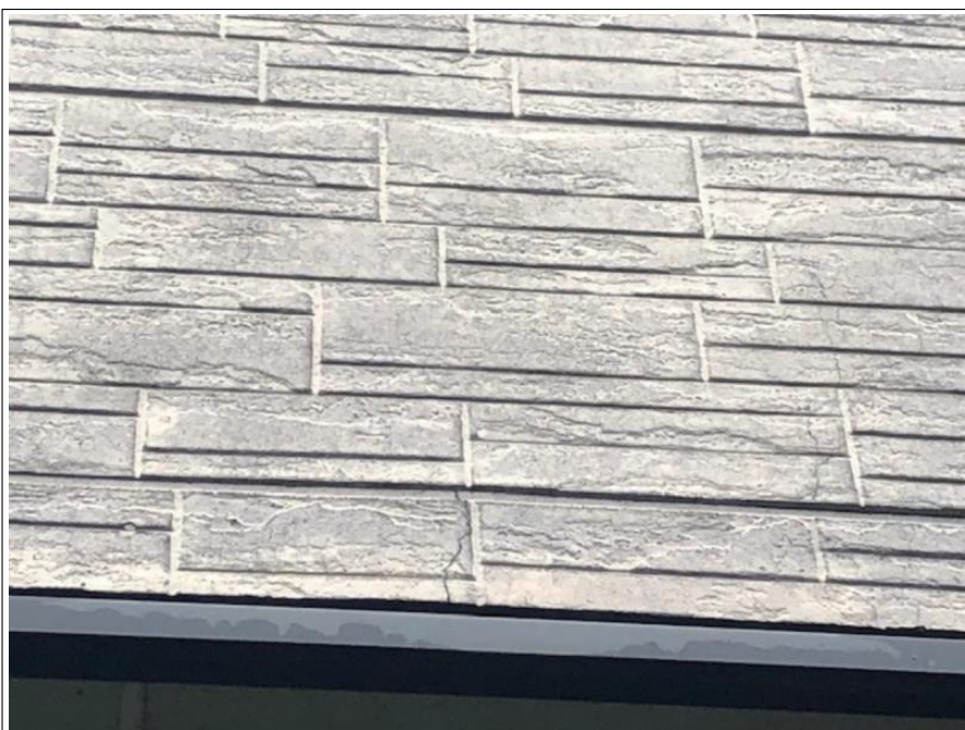
外壁 クラック部
