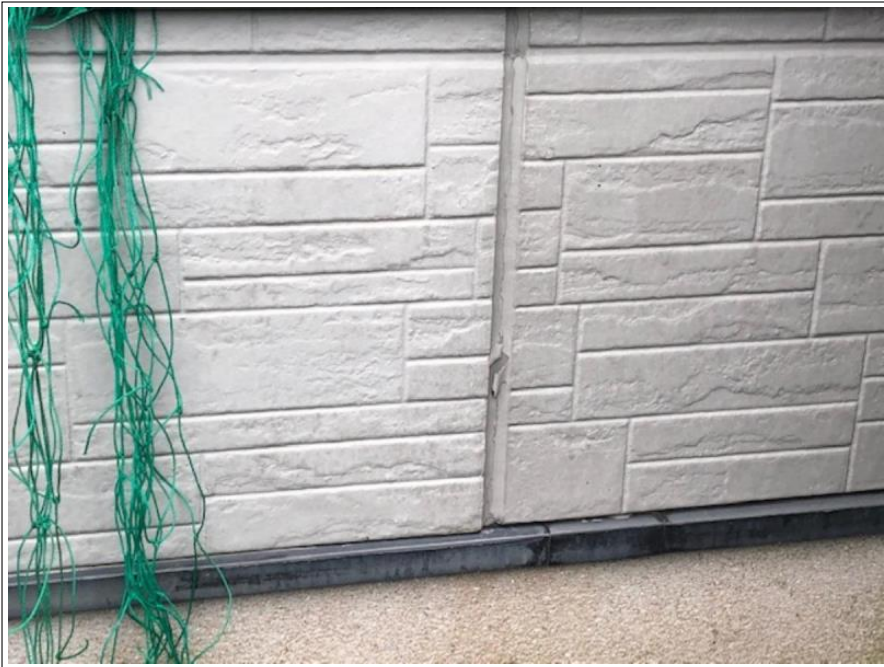
外壁 ボードシーリング劣化部
