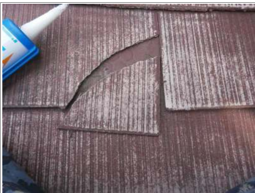
屋根破損部補修施工前
