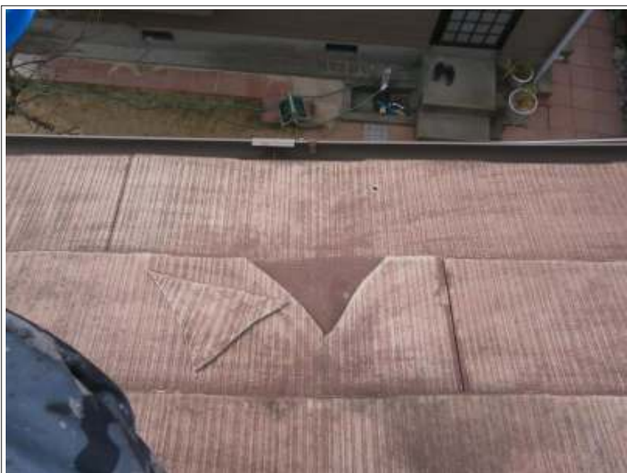
屋根破損部補修施工前
