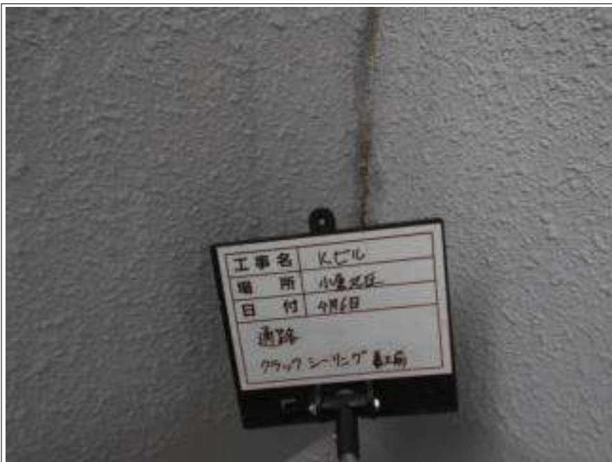
外壁 クラック補修施工前
