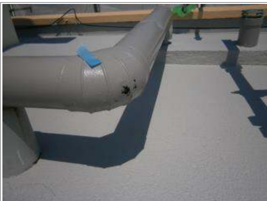
配管補修 施工前
