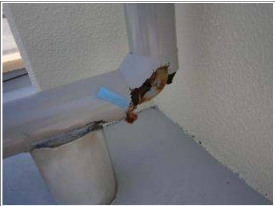
配管補修 施工前
