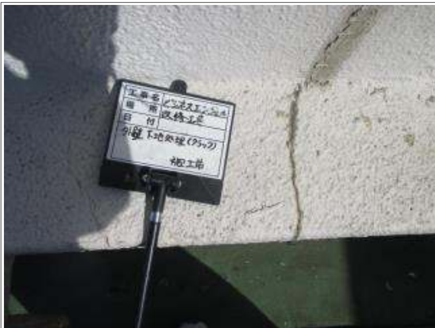
外壁 クラック補修施工前
