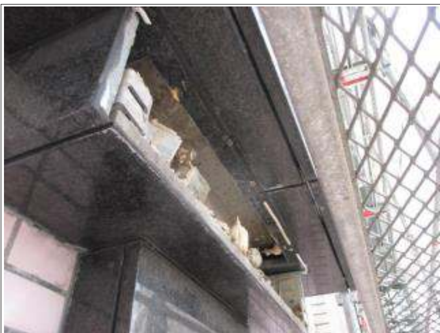
爆裂部 撤去後
