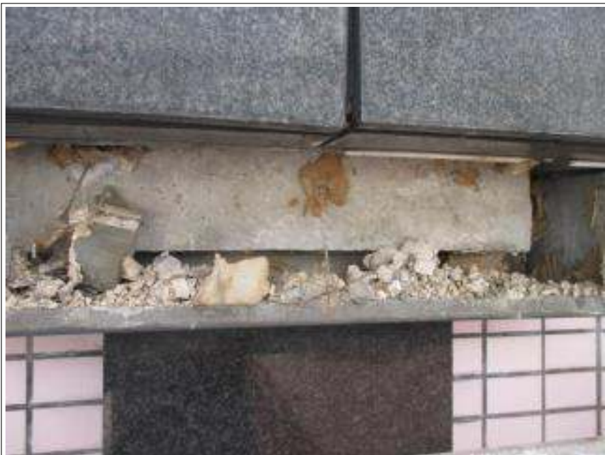
爆裂部 撤去後
