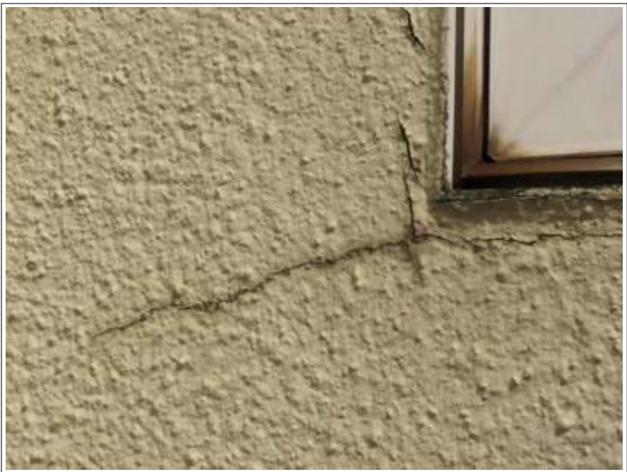
外壁 クラック部
