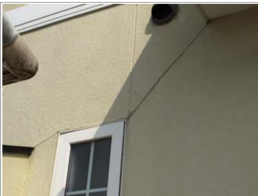
外壁 クラック部
