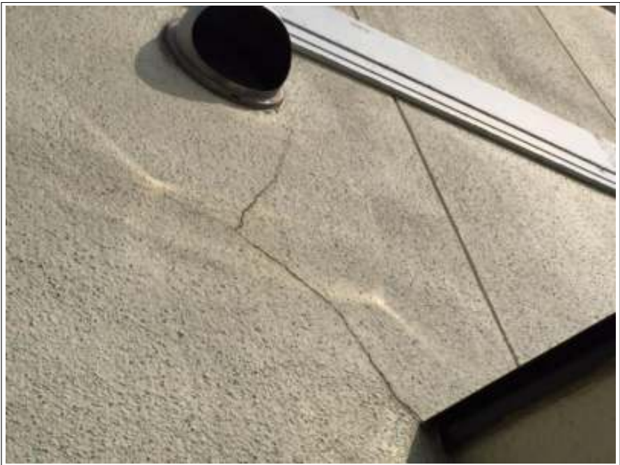
外壁 クラック部
