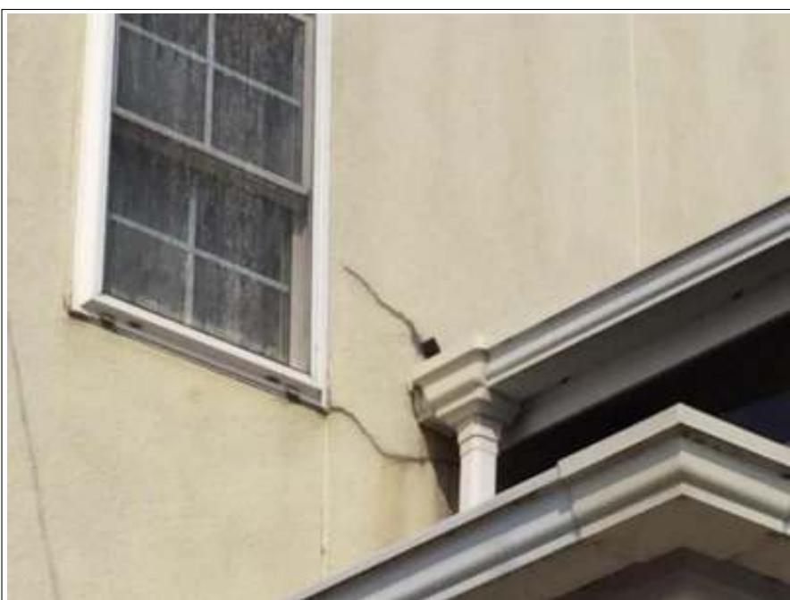
外壁 クラック部
