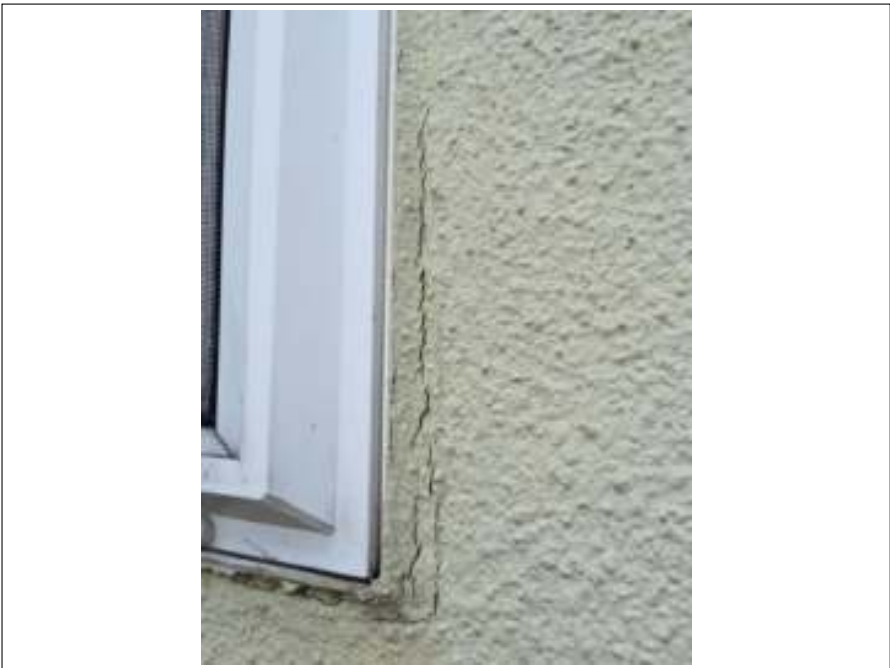
外壁 クラック部
