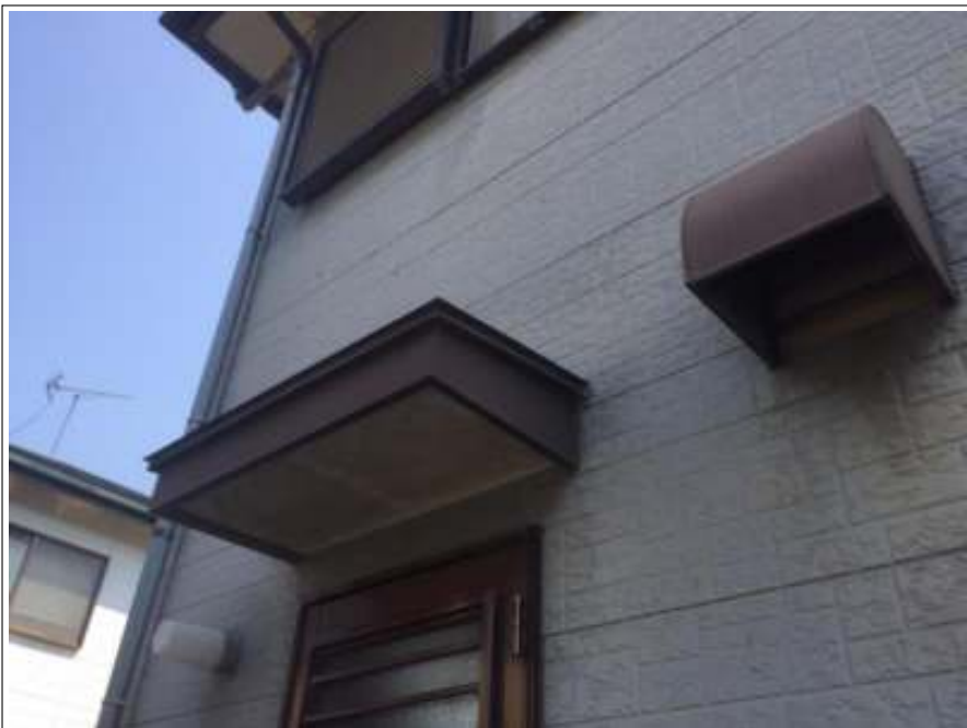
小庇・換気フード
