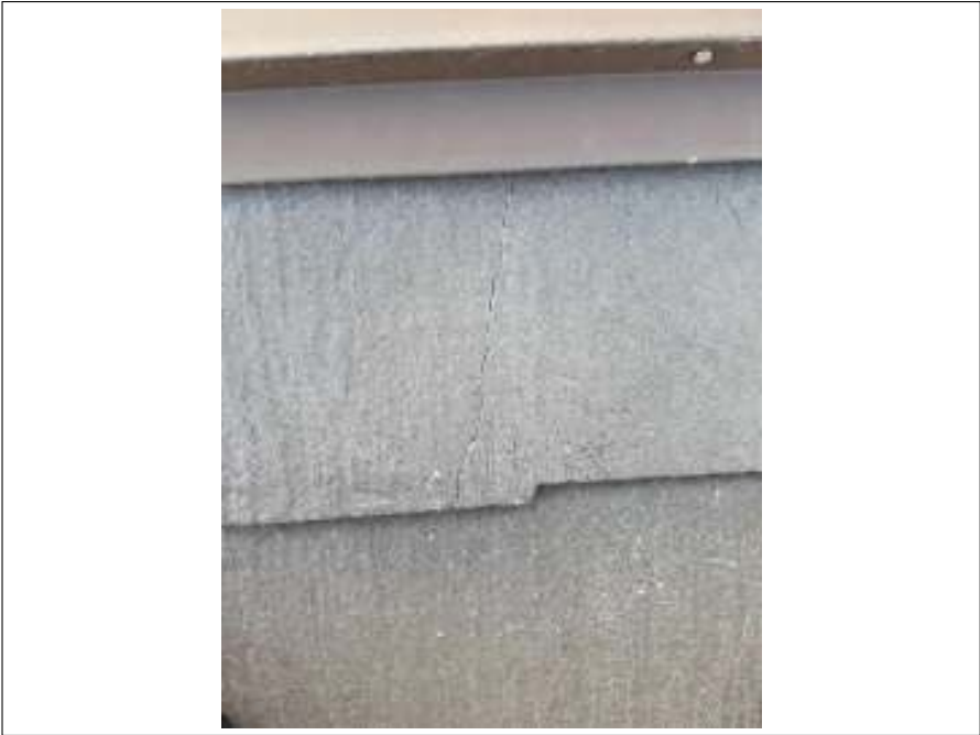
屋根 クラック補修施工前
