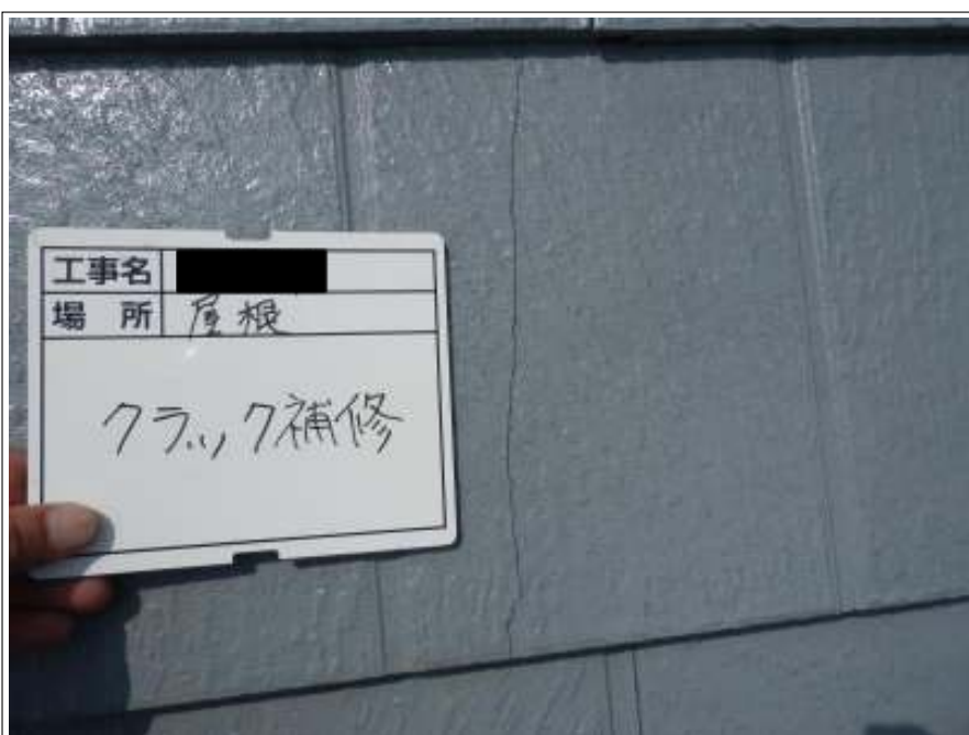
屋根 クラック補修 施工前
