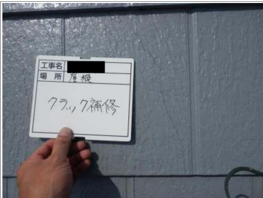
屋根 クラック補修 施工前
