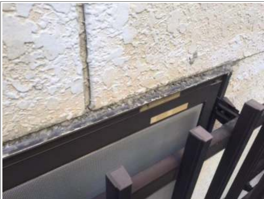
外壁 シーリング劣化部
