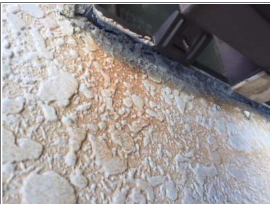
外壁 シーリング劣化部
