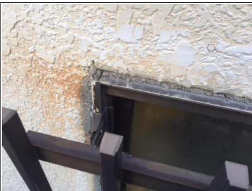
外壁 シーリング劣化部
