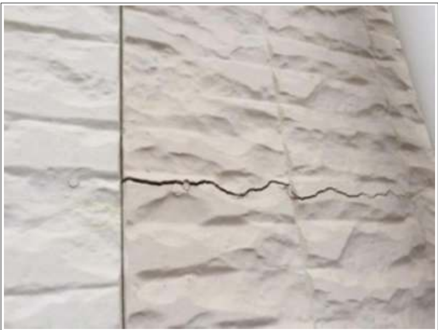
外壁 クラック部
