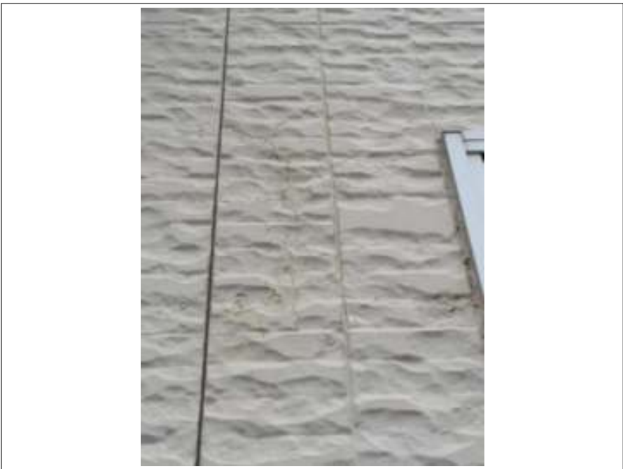
外壁 クラック部
