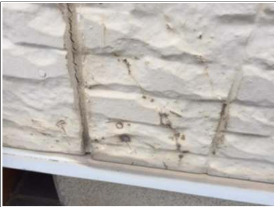
外壁 クラック部
